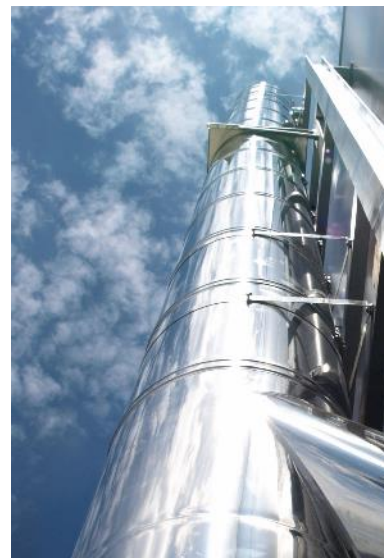
Дымоходы и энергетические системы
